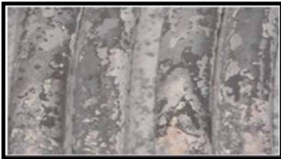
Ilustración 23. Incrustaciones formadas en tuberías internas de una caldera
