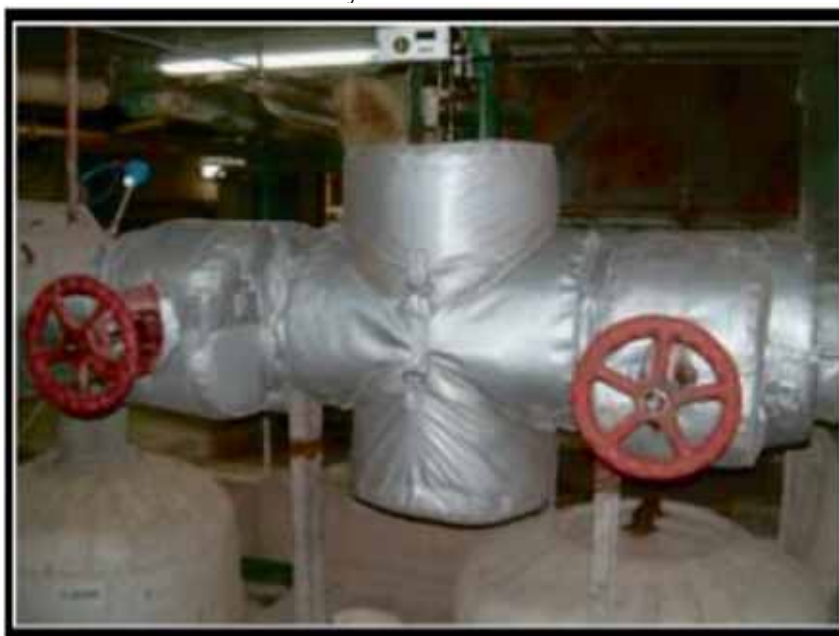
Ilustración 11. Válvula sin y con aislamiento térmico desmontable
