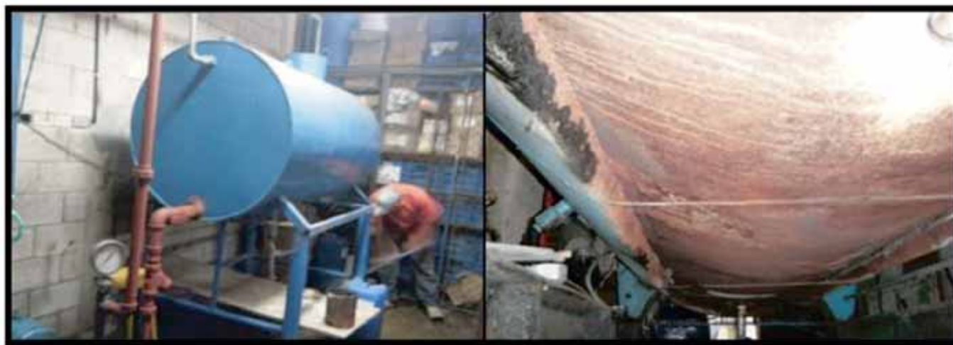
Ilustración 6. Tanques y superficies calientes sin aislamiento térmico
