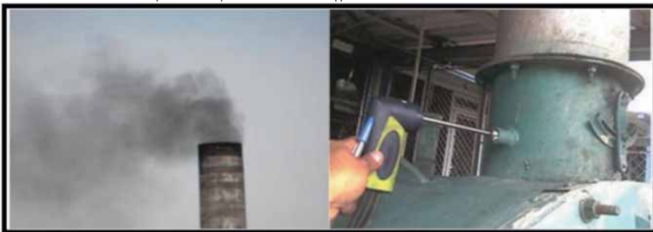
Ilustración 12. Salida de los gases de combustión de la chimenea con un nivel bajo de aire y medición de los gases de combustión en la chimenea
